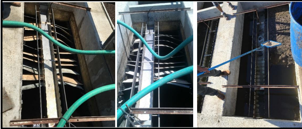
Antes: Láminas de PVC dañadas
