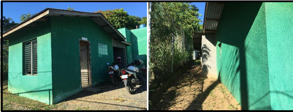
Antes: Pintura dañada
