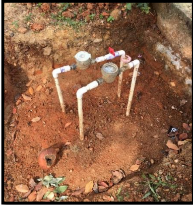
Medidor de agua potable.
