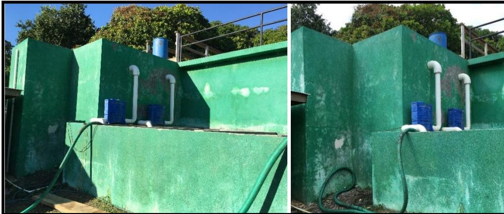
Antes: Pintura en mal estado.
